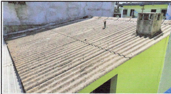
Foto 3: sustitución de duralita por lamina troquelada calibre 26 y mantenimiento de soporte de metal
